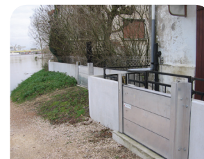
Batardeaux à Saint-Marcel © EPTB
