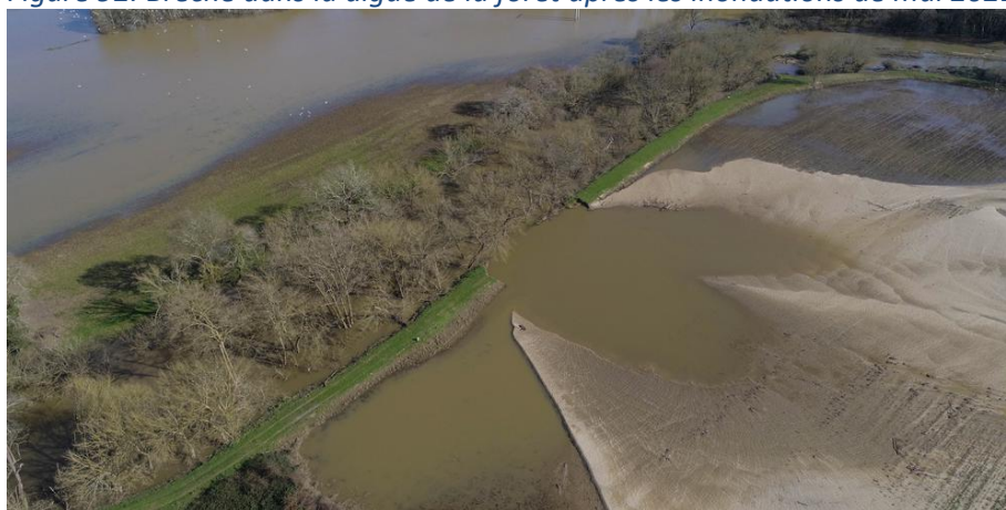
Figure 92. Brèche dans la digue de la forêt après les inondations de mai 2021
