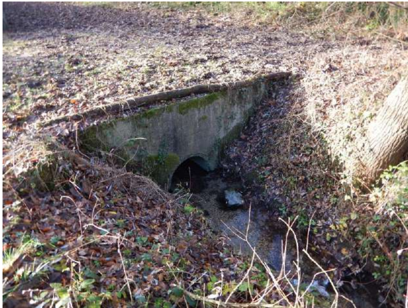
Figure 93 – Le ru de la Grande prairie est busé sur un linéaire de 370 m dans la traversée d'Arbonne
