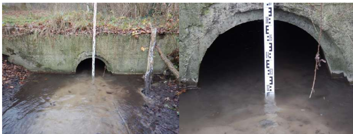
Figure 92 – Ensablement partiel d'une buse sur la partie aval du ru de la grande prairie
