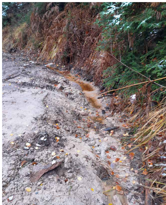
↑ Figure 8. Les fossés peuvent fortement contribuer à l'érosion. Un entretien "pointillés" (curage de 50 m tous les 50 m) plutôt qu'en plein permet de limiter les départs érosifs. En effet, l'eau qui accélère dans les parties curées est ralentie dans les zones non curées où elle peut s'infiltrer dans le sol.
