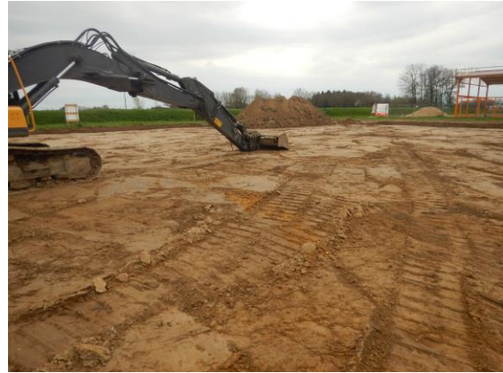
Figure 3 : Terrassement en vue de la construction d'une zone artisanale sur une zone humide de plateau en Bresse (Ain).
