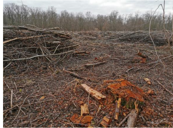
Figure 68 : Coupe à blanc d'une aulnaie en secteur alluvial en prévision d'une afforestation naturelle dans le Noyonnais (Oise). Le prestataire du maître d'ouvrage a réalisé une mauvaise identification de l'habitat forestier en état initial (plantation forestière identifiée), ce qui avait justifié à tort la coupe à blanc en vue d'une plantation plus naturelle.
