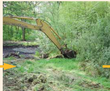
Travaux : curage du faciès comblé par la glycérie, tout en préservant la tourbière boisée.
