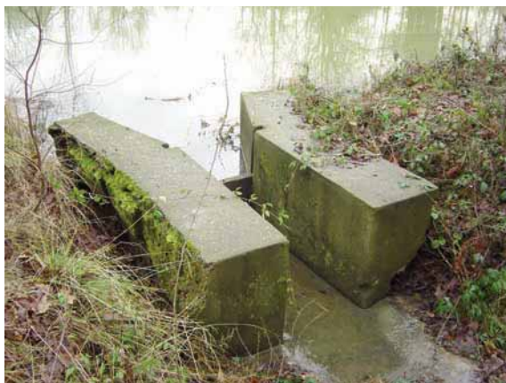
Vannage affouillé de part et d'autre de l'ouvrage
