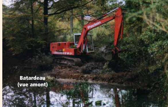
2- mise en place du batardeau, par compactage de terre argileuse. Cette mare héberge 5 espèces de tritons (cas rare en France), il est donc impossible de la mettre à sec.
