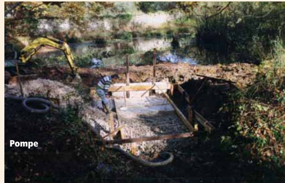
4 - les fondations sont hors d'eau. Installation du coffrage. Les matériaux sont apportés par une chenillette. Une pompe est prévue pour vider l'eau en cas d'intempéries.
