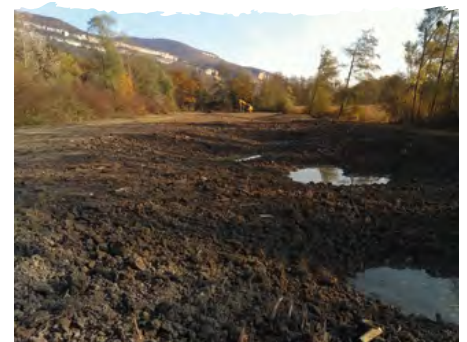
2 Terrassement d'une des anciennes peupleraies après les travaux de déboisement, pour créer un réseau de mares.
