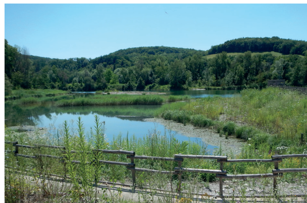
Plan d'eau n°3 après travaux : arasement d'îlot, reprofilage des berges en pente douce, création de hauts fonds
