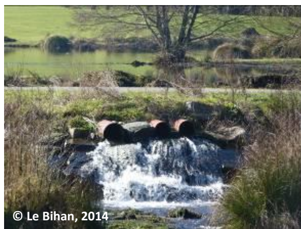
Figure 16 : Présence d'un obstacle infranchissable à l'amont immédiat du plan d'eau
