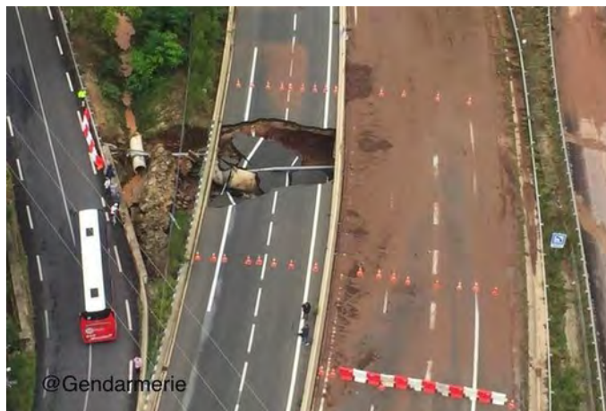
Figure 45: Effondrement de l'A75 en septembre 2015 à une cinquantaine de kilomètres à l'Ouest de Montpellier, provoqué par de forts orages, qui a entraîné une coupure de plusieurs semaines (source : Gendarmerie nationale)
