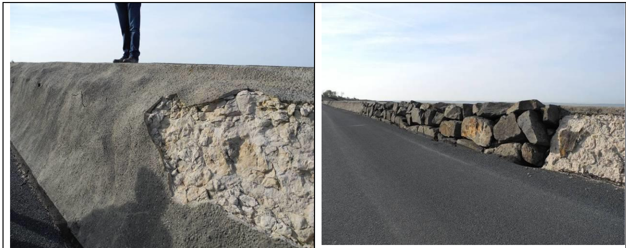
Figure 2.23 – Digue du Génie : Béton projeté coté route (éclaté par endroit suite au gonflement de la maçonnerie) et réparation d'une brèche par des enrochements liés au béton côté mer - Source Irstea.
