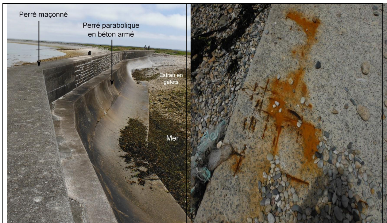
Figure 2.24 – Digue de Pors Kaïg : Exemple d'abrasion du béton par les galets - Source Cerema.
