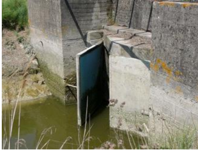
Une porte à flot à marée descendante
