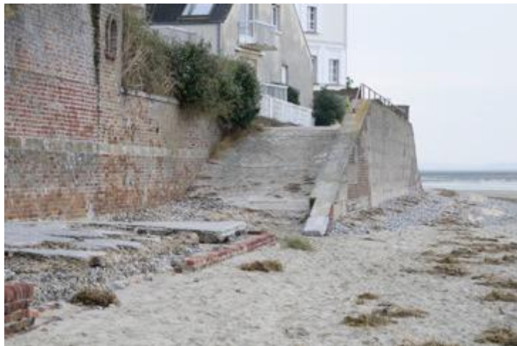
L'érosion côtière affecte également les constructions du bord de mer (Le Crotoy, Somme, France)
