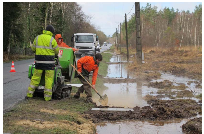
Photo 18 - Travaux de restauration hydrologique visant à limiter l'impact de la route départementale qui traverse la tourbière de la Guette [18] (© F. Laggoun-Defarge)
