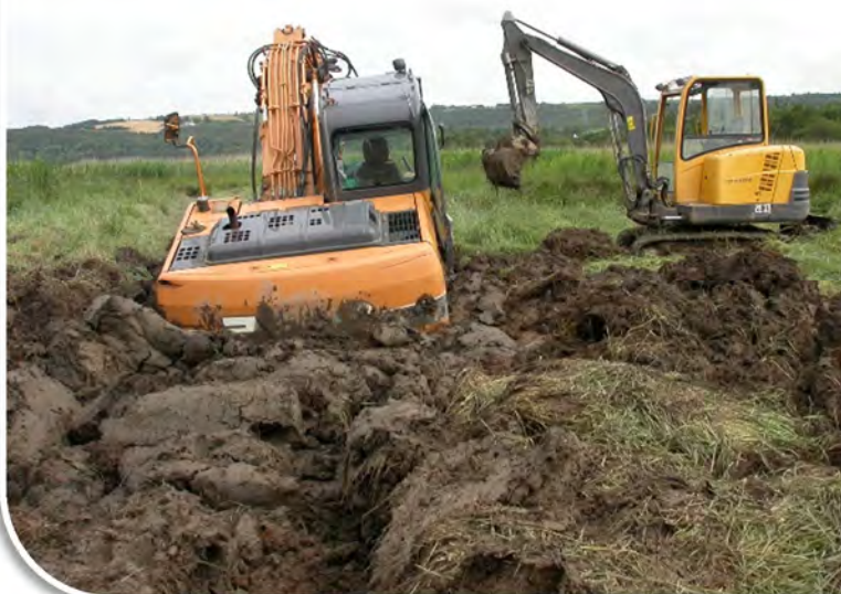
Pelleteuse trop lourde pour le sol peu portant.
