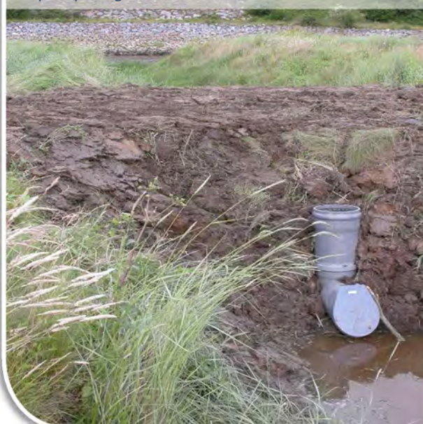
Mise en place d'un système de trop-plein et de clapets pour gérer le niveau d'eau d'un marais.
