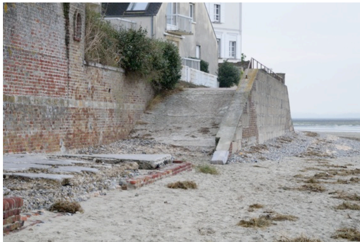
Figure 58 : l'érosion côtière affecte également les constructions du bord de mer (Le Crotoy, Somme, France)
