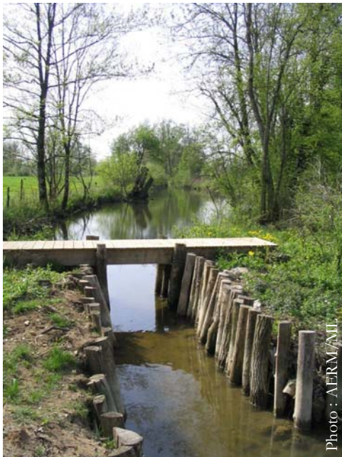
Passerelle et ligne de pieux installées au débouché de la petite noue
